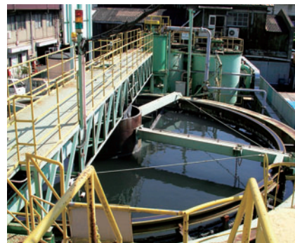
シクナー（凝集沈降槽）
