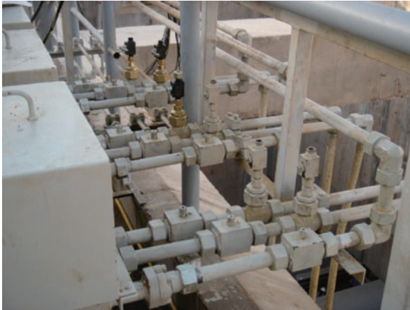
図10 油圧配管エア抜き用バルブ
