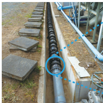
通水実験管路の外観
