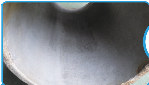
38年間通水試験後の管内面の状況（下側が管頂部）
