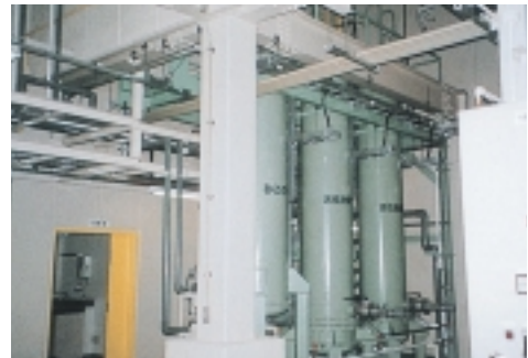
高度処理設備
